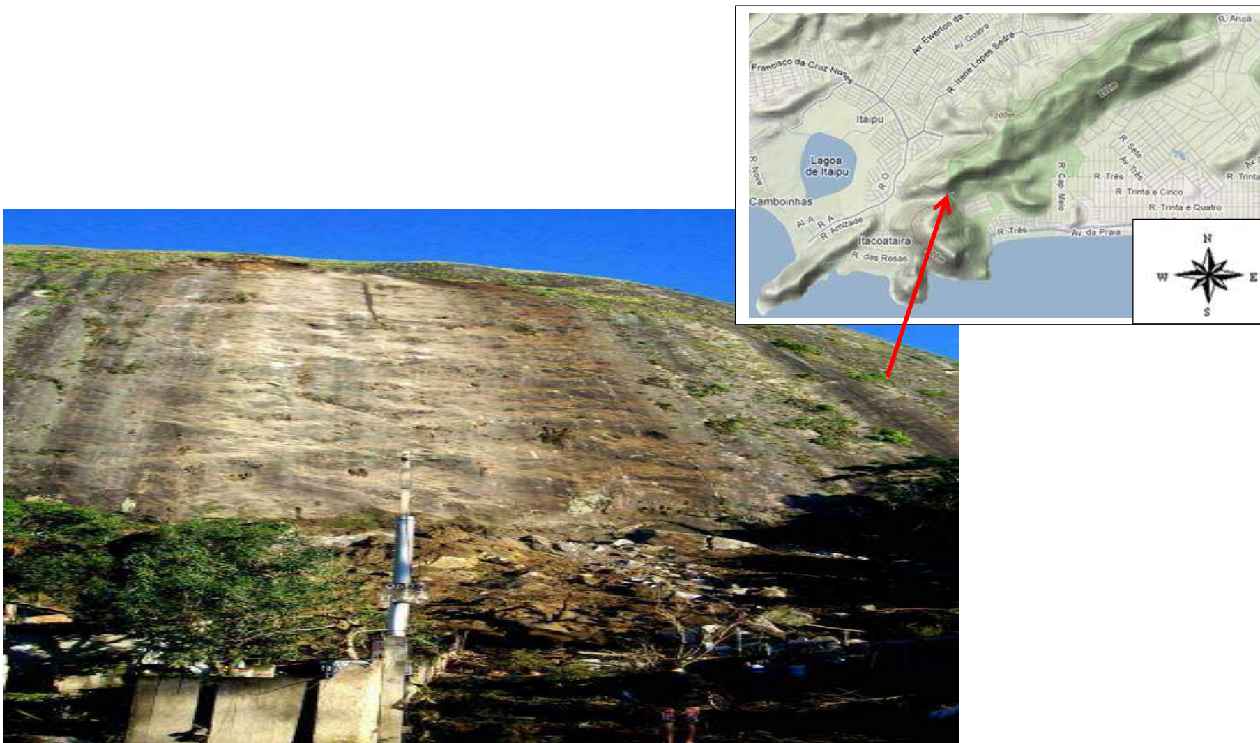
Figura 15 - Encosta deslizada no Maciço da Serra da Tiririca, em agosto de 2009.
